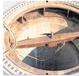
Das ist kein einfacher Gully: der Schachtdeckel mit 92 Zentimeter Durchmesser ist 50 Kilogramm schwer und an einer Quertraverse befestigt
